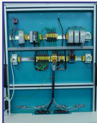
Sterownik zabezpieczeń stanowiska do regulacji poziomu cieczy
