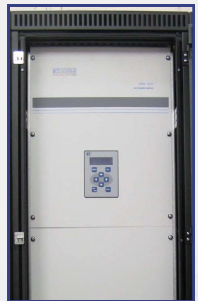
Zasilacz grzałek dużej mocy zamontowany w szafie sterowniczej
